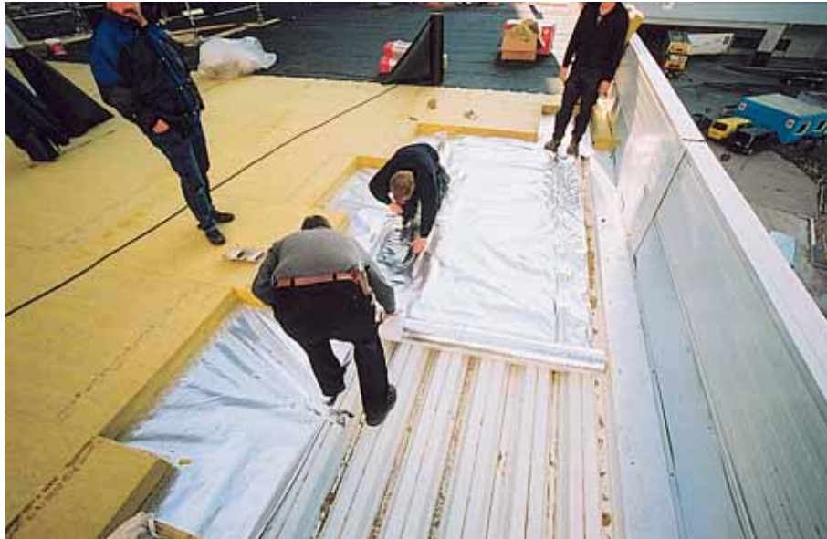
← Die einzelnen Schichten der einschaligen Konstruktion: Dampfsperre, Dämmung und Abdichtung wurden in Teilabschnitten aufgebracht.
