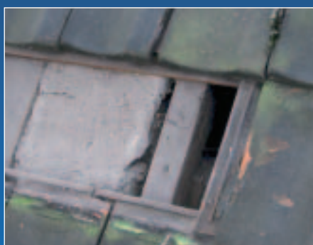
Des fissures et ouvertures manifestes, des ponts thermiques inévitables.
