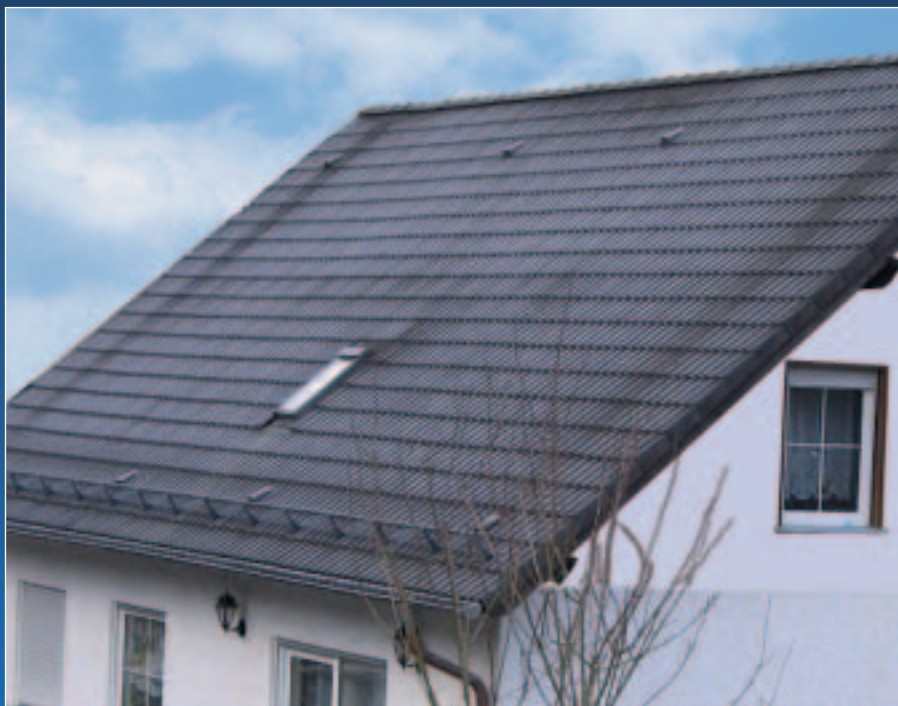
Des ponts thermiques au niveau des murs de façades : visibles de loin.
