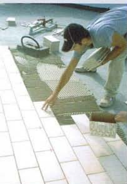
Impermeabilizzazione di coperture piane e terrazzi con guaina liquida bicomponente a base di cementi e polimeri sintetici in dispersione acquosa (Dermacem, di Casali).
