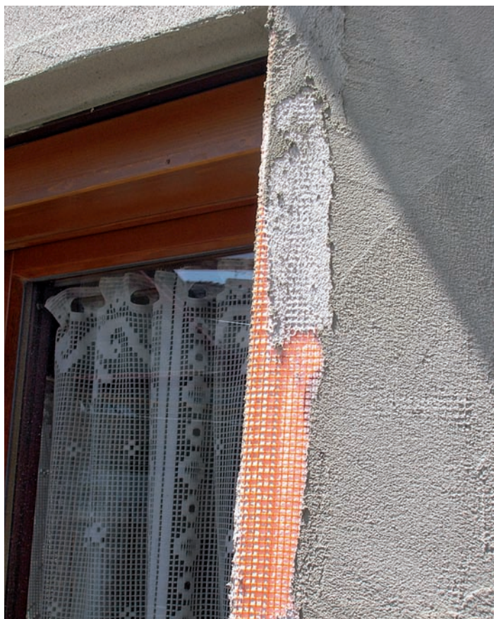
L'armatura in rete in fibra di vetro a maglie strette è stata successivamente rasata con specifico prodotto ad alta traspirabilità
