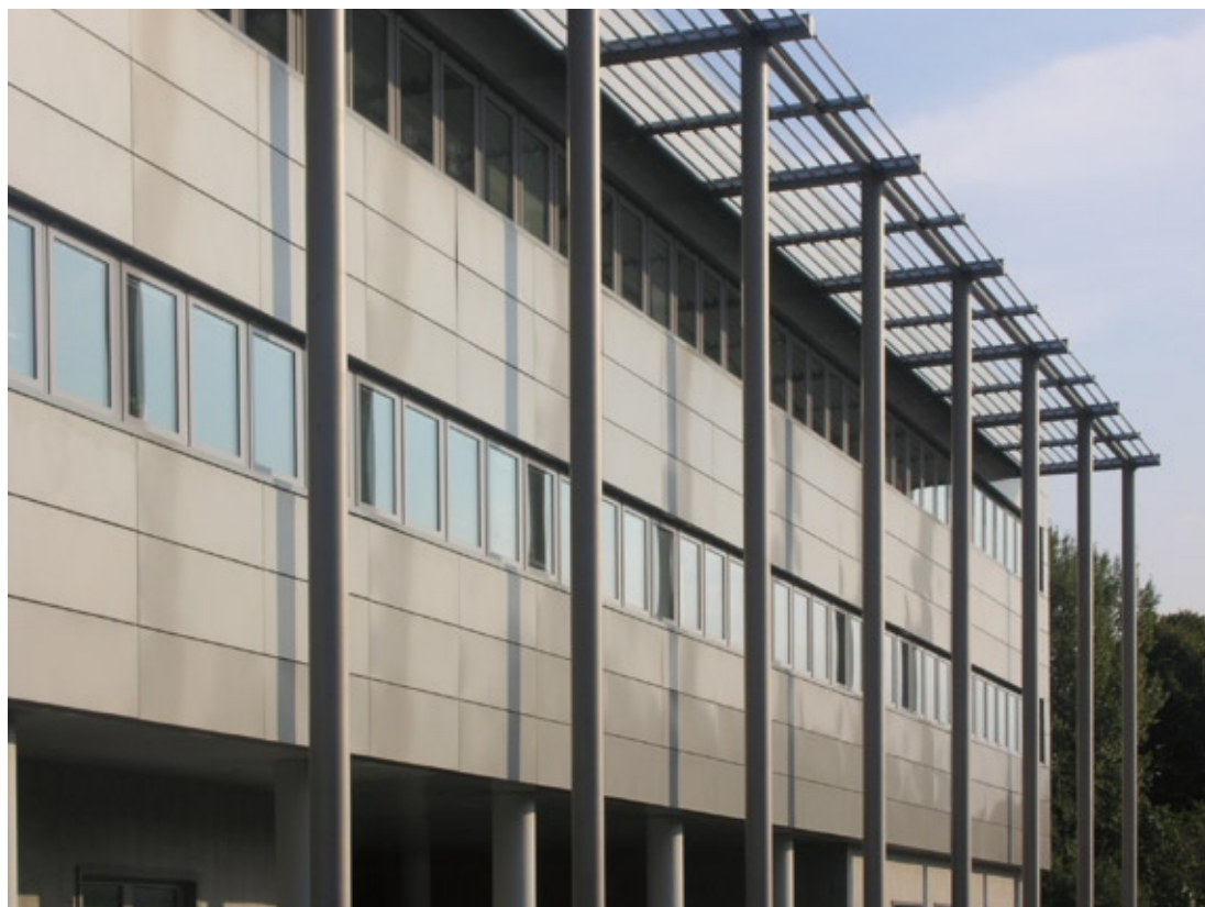
Nuova sede degli Uffici Comunali a Formigine. Brise soleil in facciata (cfr Modulo 343, pag. 716).
