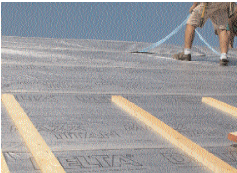
Sopra: fissaggio ermetico delle sovrapposizioni della termomembrana DELTA®-Maxx TITAN grazie alle bande adesive integrate; Sotto: sezione del pacchetto tetto a risparmio energetico grazie all'uso della barriera al vapore riflettente DELTA®- REFLEX PLUS (sotto l'isolamento) e della termomembrana traspirante DELTA®- MAXX TITAN (sopra l'isolamento)
