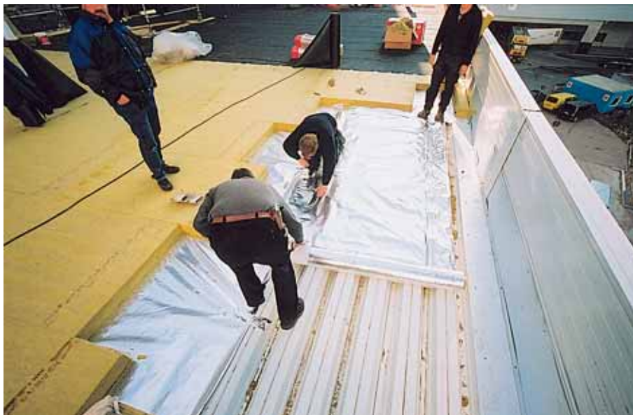
← Die einzelnen Schichten der einschaligen Konstruktion: Dampfsperre, Dämmung und Abdichtung wurden in Teilabschnitten aufgebracht.
